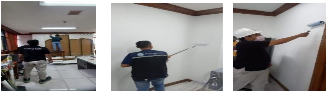
Gambar 5. Pengawasan dan Pelaksanaan Perbaikan Ruang FT.Teknik Lantai 7,Gedung A Universitas Mpu Tantular.
