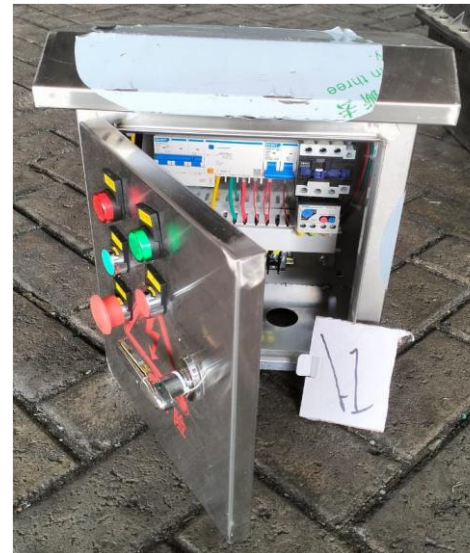
Gambar 8. Box Panel Listrik.
